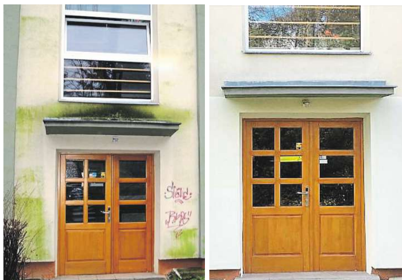
Bez řas Plísně a řasy jsou čím dál větším problémem především zateplených domů. Díky novému objevu je možné s řasami účinněji bojovat. Na snímku vlevo je dům se zašpiněnou fasádou, vpravo po postřiku. Foto: Pragotherrm
