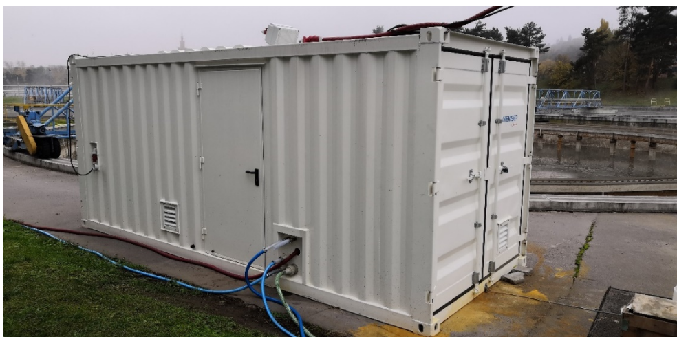
Obr. 1: Poloprovodní jednotka pro recyklaci odpadních vod
